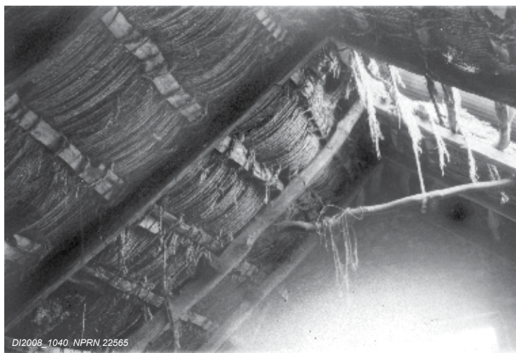
Uchod: Rhaffau gwellt y defnydd o dan y to yn pydru yn ysgubor Croftufty, Tyddewi, Sir Benfro.
